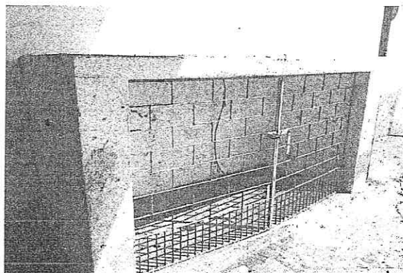
ÁREA EXTERNA - ABRIGO DO COMPRESSOR.
