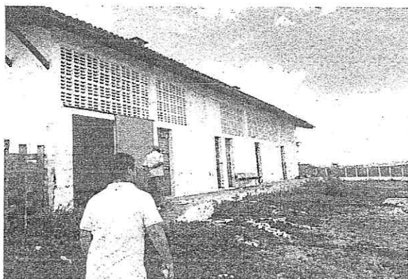
ÁREA EXTERNA - PINTURA DA PAREDES EXTERNAS DO PRÉDIO DANIFICADA DEVIDO A AÇÃO DO TEMPO. PORTAS SERÃO SUBSTITUÍDAS.
