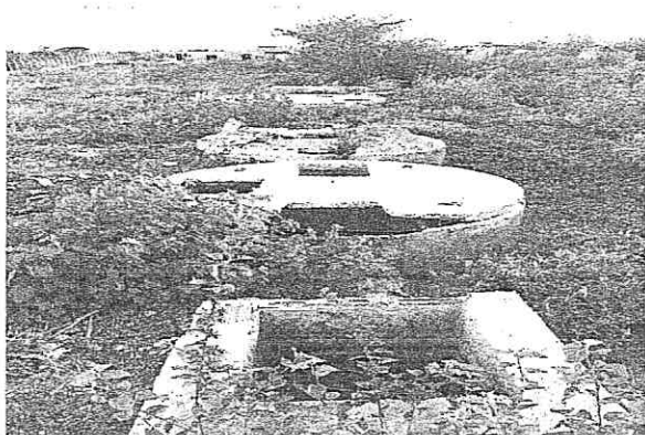
FOSSA/SUMIDOURO - TAMPAS DE CONCRETO DANIFICADAS.
