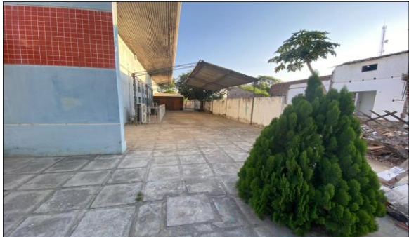
ESPAÇO PARA A REFORMA E AMPLIAÇÃO (CONSTRUÇÃO DE DUAS SALAS) NO NÚCLEO DE ARTES E CULTURA (NAEC) JOSÉ ASSEF FARES.
