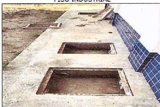
TAMPA DE CAIXA DE PASSAGEM
