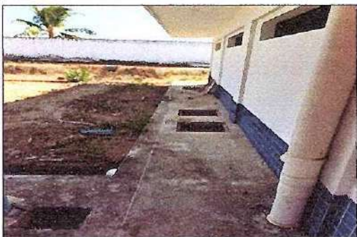
TAMPA DE CAIXAS DE PASSAGEM
